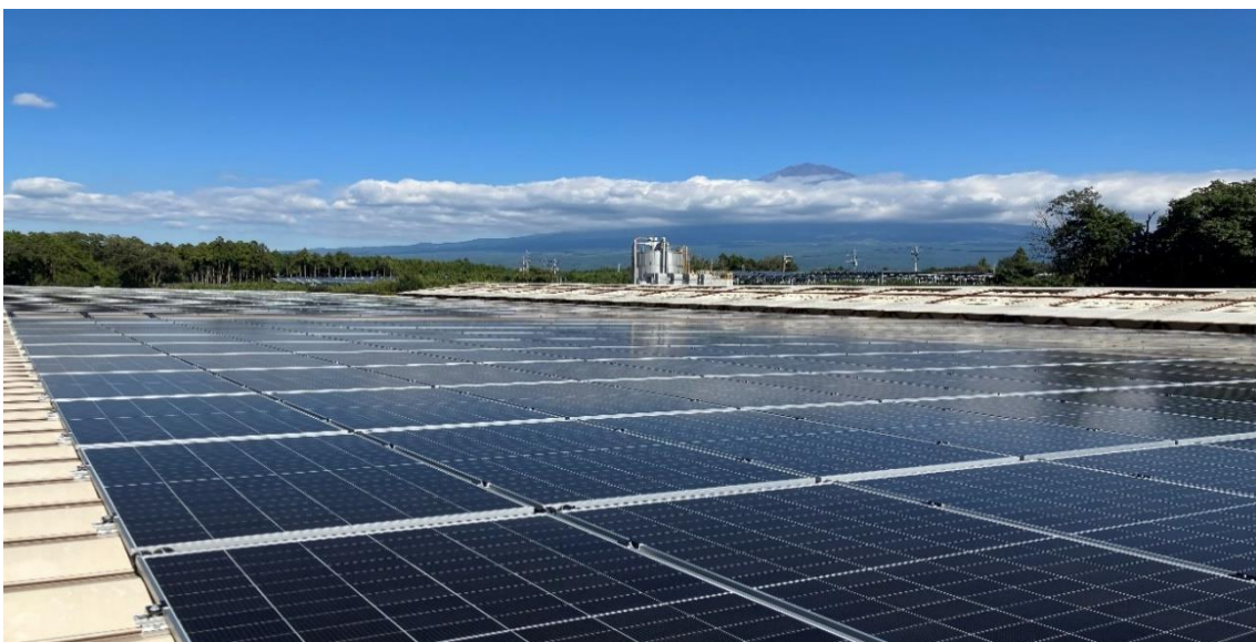
「太陽光パネル設置例 院庄林業株式会社様富士宮工場」
